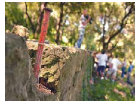
Cordeau fixé dans le mur grâce à une pointerolle (restauration de la partie haute du mur).
