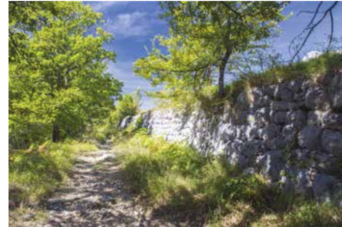
En façade, le fruit d'un mur qui penche, Gréolières.
