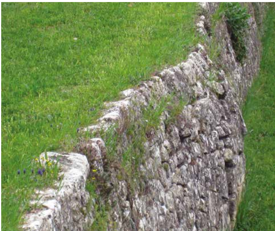
« Gonflement » du mur, Plascassier, Grasse.
