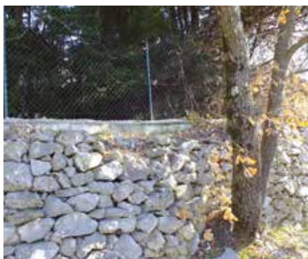
Insertion de clôture fortement visible du fait du muret en parpaings surplombant directement le mur en pierre sèche. À éviter!
