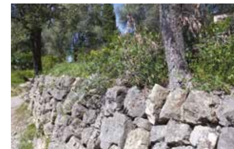
Oliviers plantés en bordure de mur : leurs racines risquent de l'endommager, Opio.
