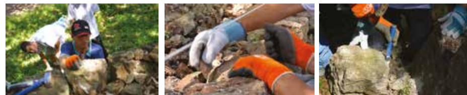
La pierre sèche : des pierres, des hommes et un savoir-faire, chantier à Antibes
